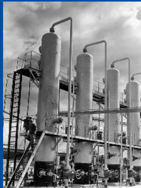
Kontaktoru iekārtas gāzes sausināšanai. 1970. gada 24. augusts.
